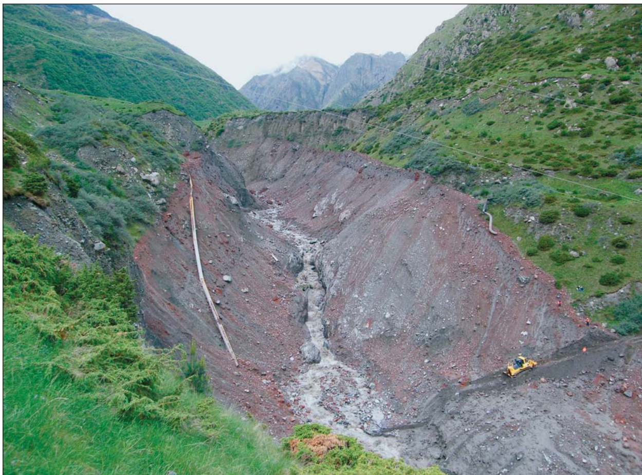
Разорванный газопровод и нарезка временной дороги для его восстановления. 20 мая 2014 г.
